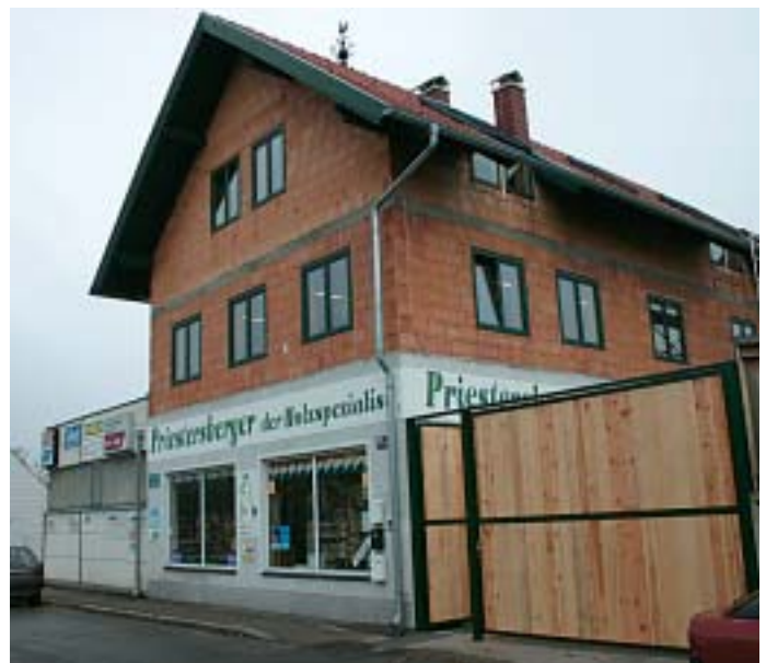
Bürogebäude in Wr. Neustadt wurde aufgestockt: Fassade soll in Schwarzkiefer ausgeführt werden
